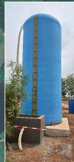
Réservoir de stockage eau traitée de 15 m 3
