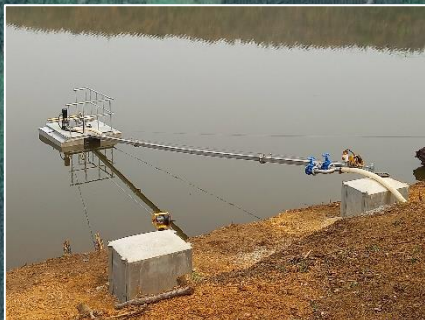
Barge flottante de pompage d'eau du lac de Bakro
