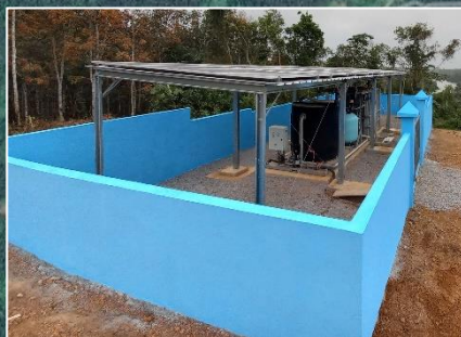
Unité de traitement avec toiture photovoltaïque et pompage vers le réservoir
