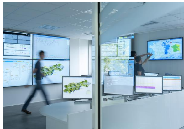
Centre VISIO – Pilotage à 360° et en temps réel des services d'eau et d'assainissement - © SUEZ / Antoine Meyssonier
