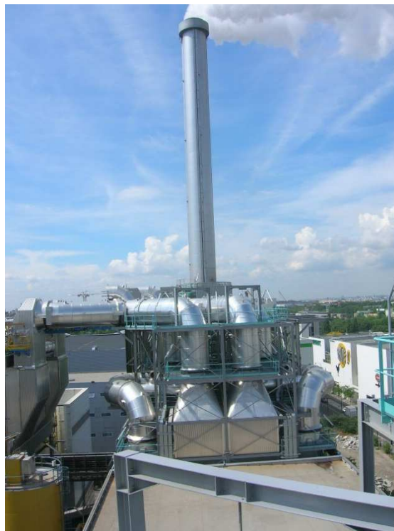
Figure 1 - vue d'une ligne de traitement des fumées
