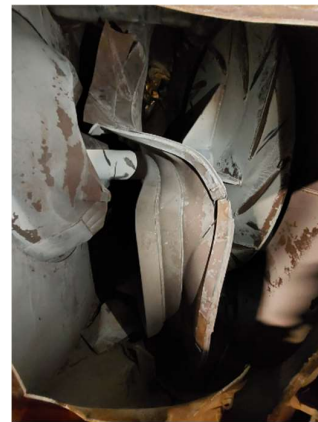
2: Roue et aubes déformées et cassées
