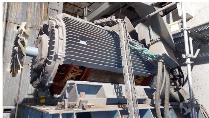
3 : Cage-châssis du bloc moteur arraché en partie basse + endommagement bobinage inférieur
