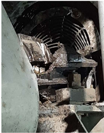
1: Cages paliers avant et arrière détruites
