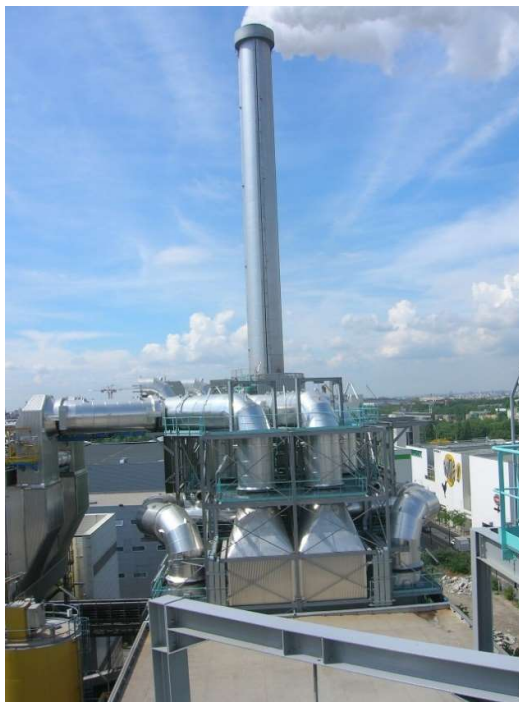
Figure 1 - vue d'une ligne de traitement des fumées
