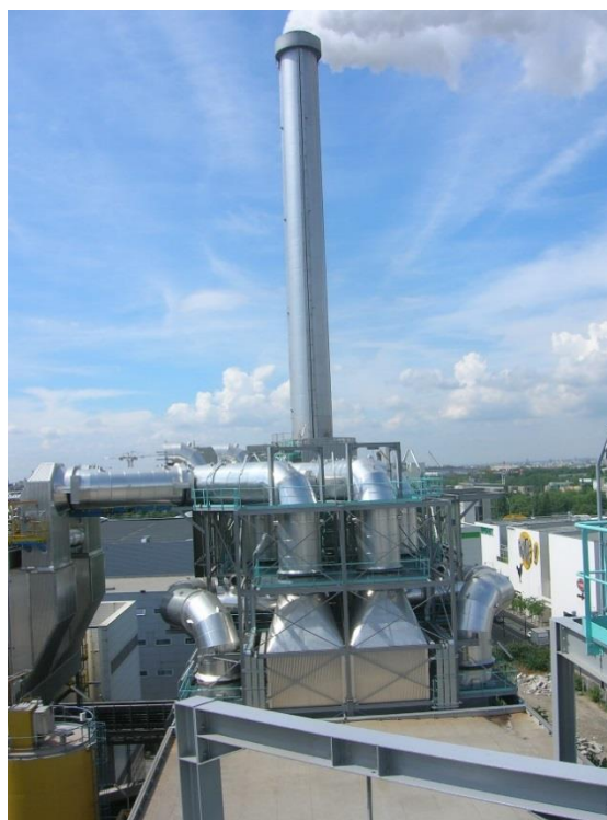
Figure 1 - vue d'une ligne de traitement des fumées
