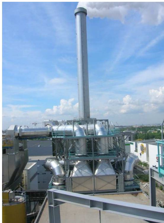
Figure 1 - vue d'une ligne de traitement des fumées
