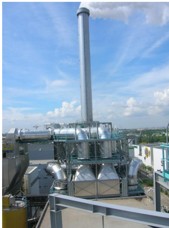
Figure 1 - vue d'une ligne de traitement des fumées
