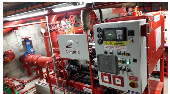
Nouveau groupe motopompe du système de lutte contre
