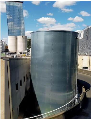
Cuve de réserve en eau d'un volume de 558 m 3 du système de lutte contre l'incendie
