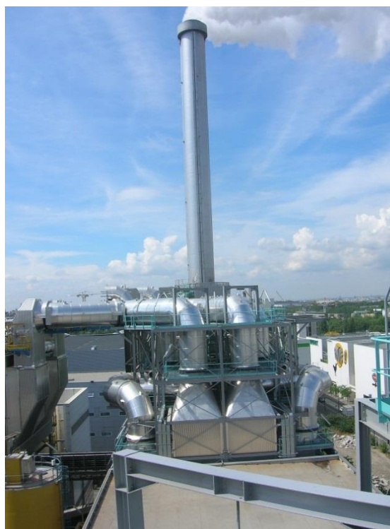
Figure 1 - vue d'une ligne de traitement des fumées
