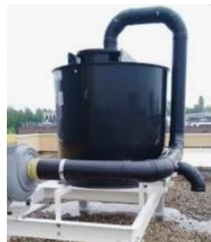
Torre carbon activo
