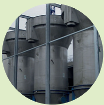
usine des Anserailles (59), France 3 000 à 4 000 m 3 /h
